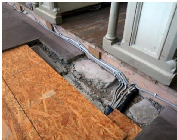
Heizungsschacht als Kreuzungsstelle für die Verkabelung der Sitzbänke
